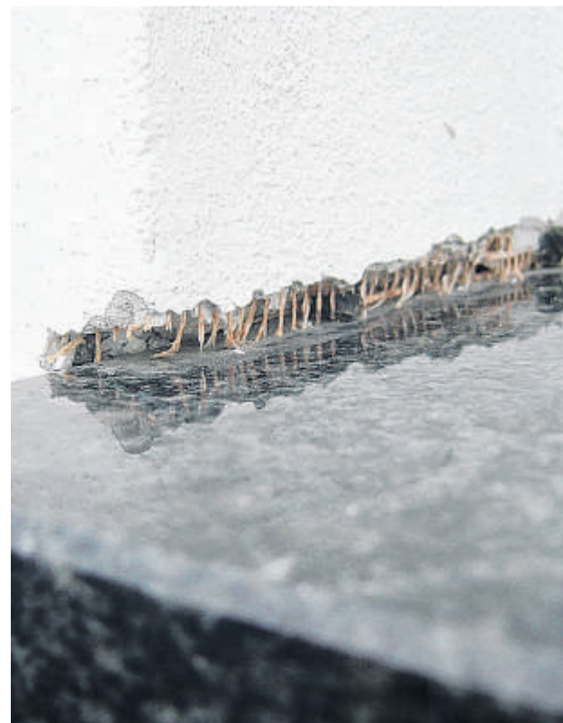
Durch Schäden an der Fassade wie hier kann Feuchtigkeit eindringen. Seit vier Jahren wird darüber Beweis erhoben. Foto: privat
